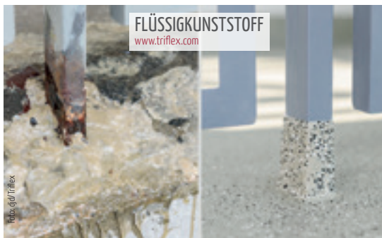
Bei einem nicht akkurat abgedichteten Balkongeländer droht das Eindringen von Feuchtigkeit (links). Mit Flüssigkunststoff lassen sich Details und Übergänge unterschiedlicher Materialien langzeitsicher abdichten (rechts).
